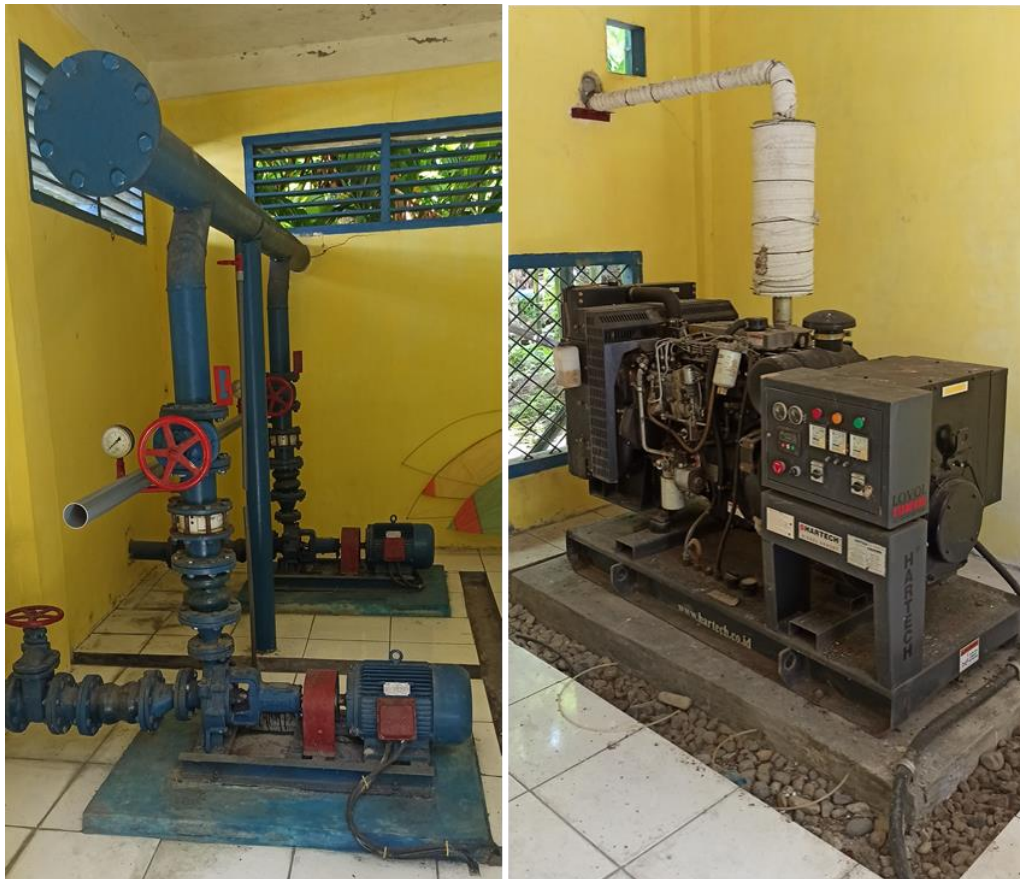
Gambar 1.25. Ruang Pompa dan Ruang Genset IKK Babahrot.
