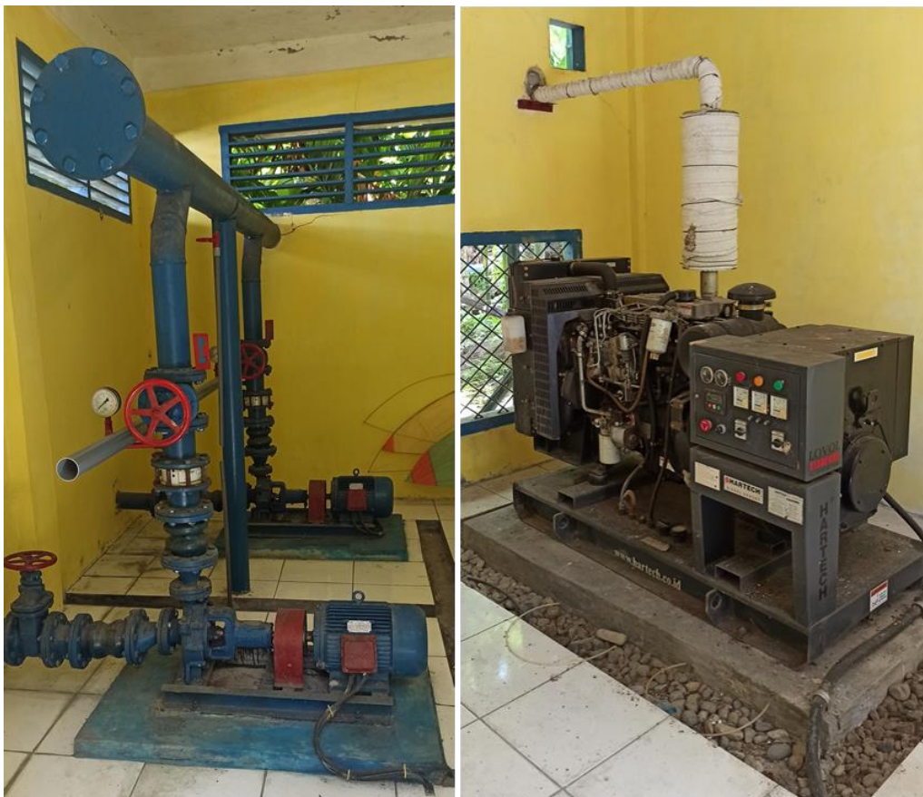
Gambar L15. Ruang Pompa dan Ruang Genset IKK Babahrot.
