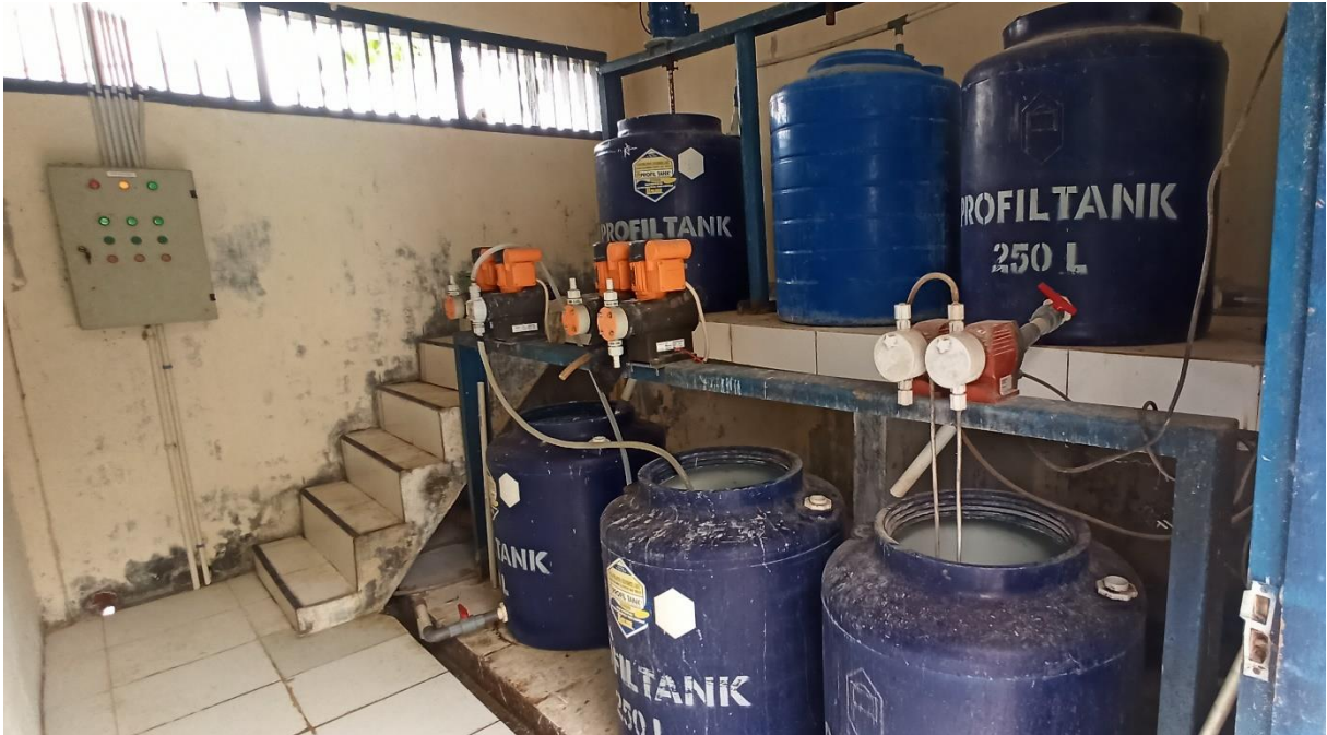
Gambar 1.15. Ruang Injeksi Koagulan IKK Lembah Sabil.
