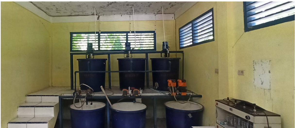
Gambar 1.26. Ruang Laboratorium Mini dan Ruang Injeksi Koagulan IKK Babahrot.
